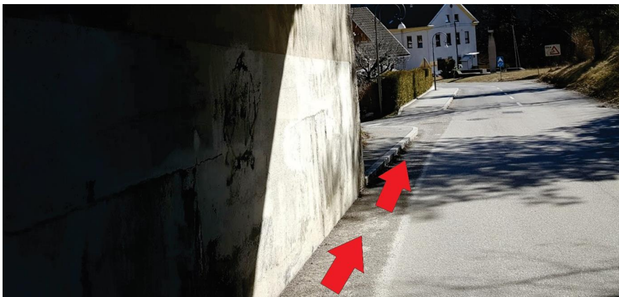
Slika 42: Nevarni odsek v Zgornji vasi pod železniškim nadvozom
